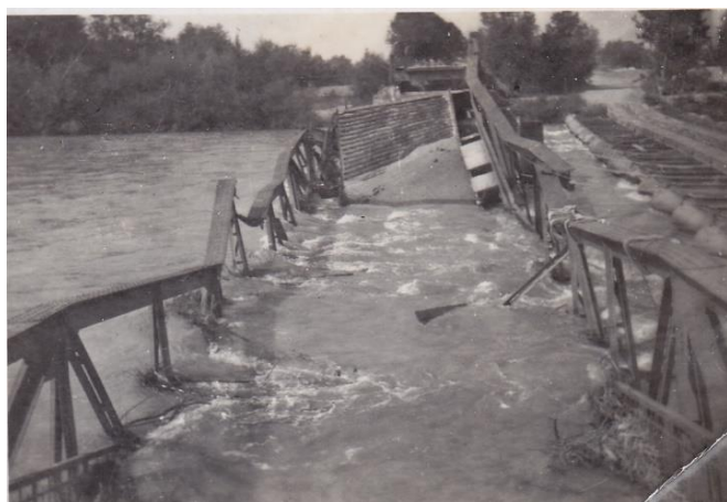
Die zerstörte Lechbrücke (Das Bild wurde zur Verfügung gestellt von Franz Müller. Vielen Dank)
